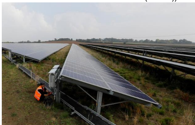
Figure 11 : Chemin de câbles (hors sol)
